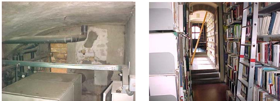
Fig. 8 Planta de calefacción y vista del interior
